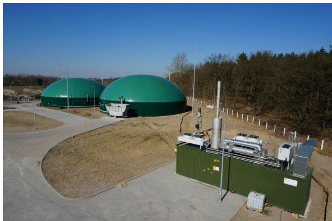
Rys. 22 Biogazownia rolnicza Brzeżno (woj. zachodniopomorskie)
