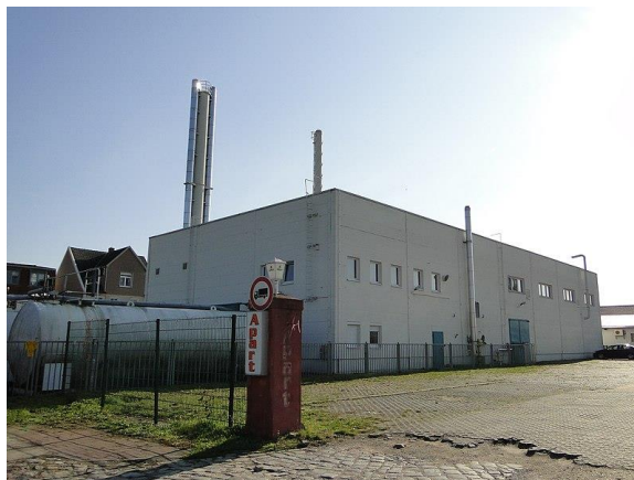
Rys. 24 GEOTHERMISCHE HEIZZENTRALE NEUBRANDENBURG
